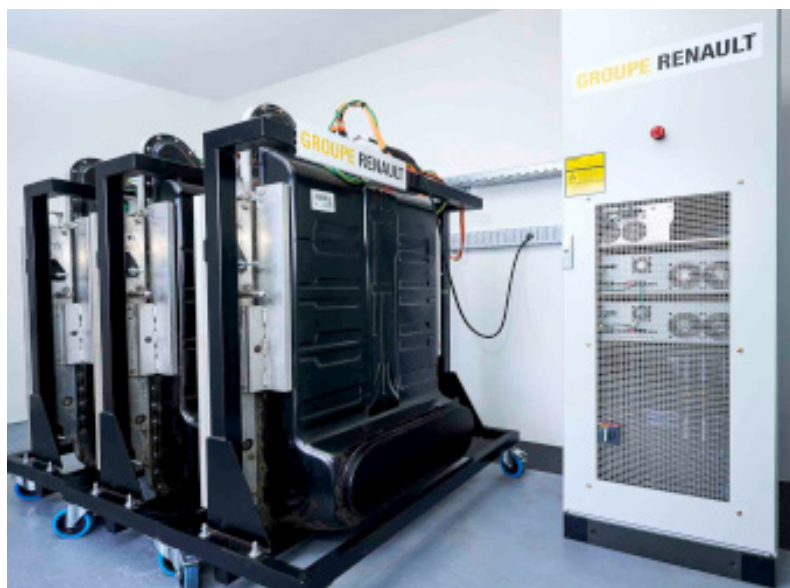
Figura 2 – Baterías de Renault Zoe eléctrico en carga para edificio.
